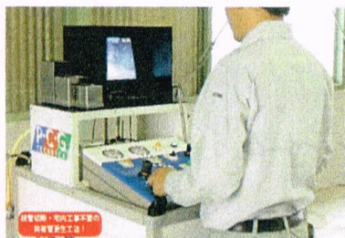
管内カメラで確認して分岐部枝削孔とライニング加工
